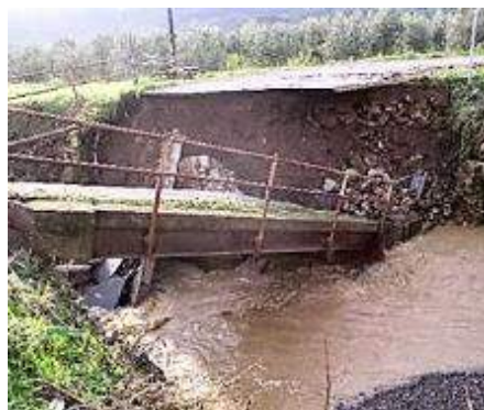
ponte crollato a seguito alluvione
